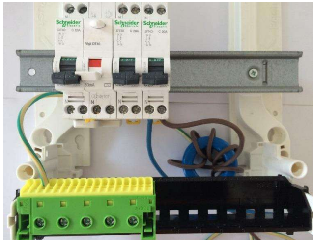
Afbeelding 8: gemonteerde ferrietringen in een enkel fase groepenkast/meterkast
